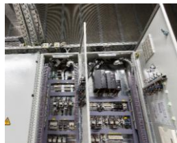
配電盤/キュービクル
